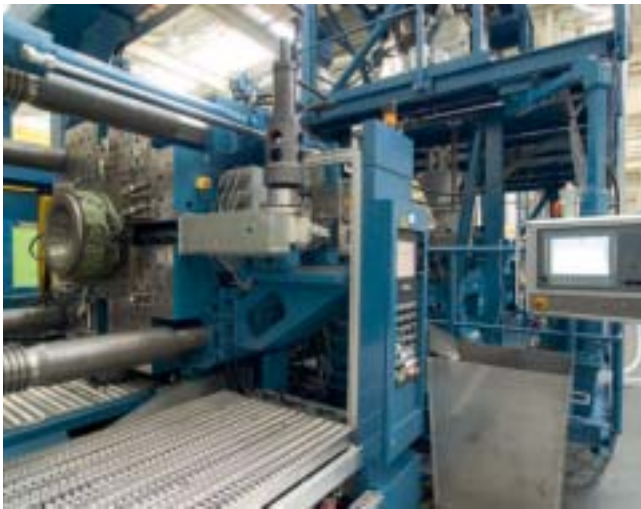
Am rechten Ende der Schmelzeleitung von der Compoundieranlage zum Spritzzylinder der Spritzgießmaschine befindet sich der Speicher zur Pufferung der Schmelze während des Einspritzvorgangs
